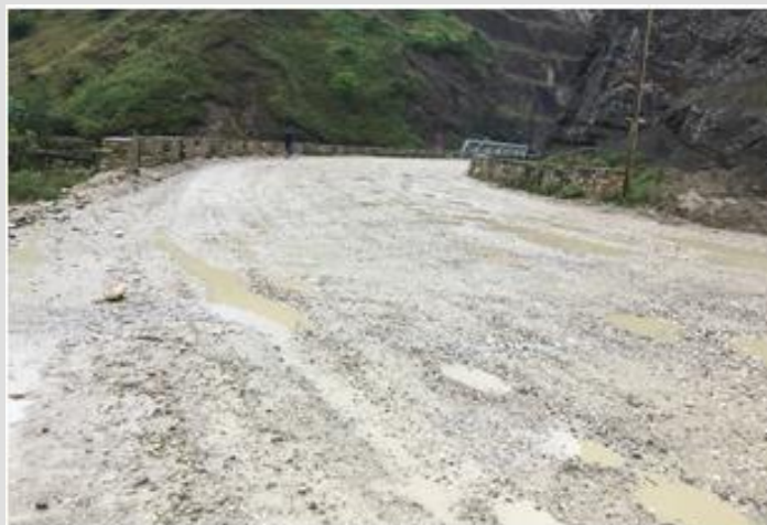
Photos : 1, 2 et 3 : Ouvrage de consolidation d'un passage étroit et zone à dynamiter pour élargir la voie
